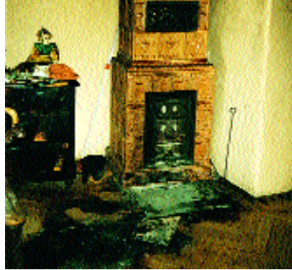
Feste Brennstoffe zu nahe und ohne Wärmeschutz an der Feuerstätte gelagert
